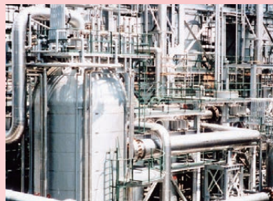
プラント配管
