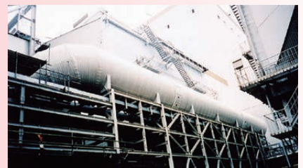
排ガス丸ダクト
