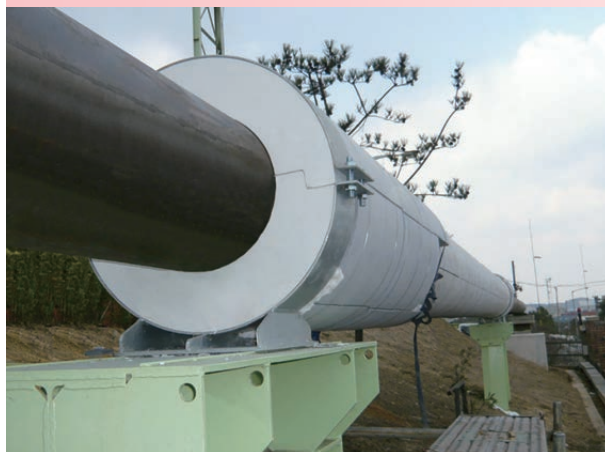
サーモカットリング/蒸気配管
