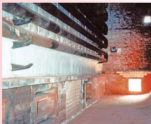
加熱炉内部無機繊維系保温断熱材ブロックライニング
