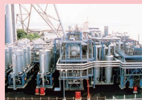
プラント配管
