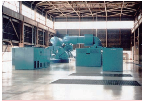
蒸気タービン
