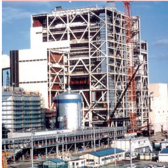
電力石炭焚ボイラ
