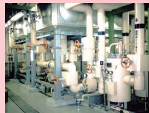
ビル空調機器
