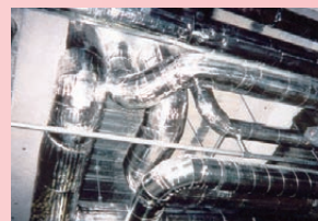
ビル空調配管，ダクト
