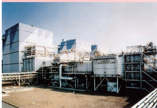
発電プラントの排気ガスの脱硝、脱流、集塵施設
