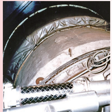
ガスタービン (排気ダクト)
