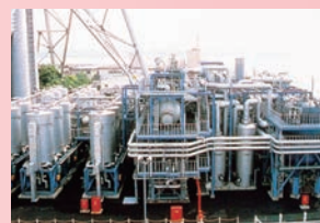
プラント配管
