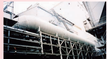
排ガス丸ダクト
