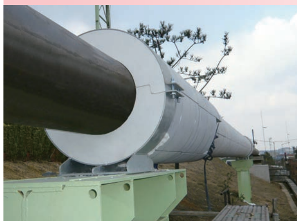
サーモカットリング／蒸気配管
