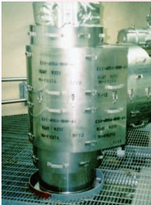
原子力配管金属被覆保温
