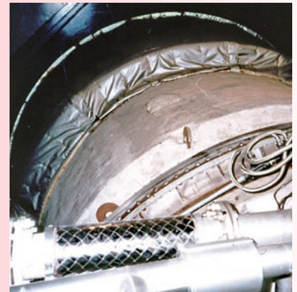
ガスタービン (排気ダクト)
