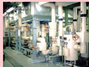
ビル空調機器
