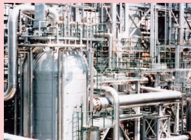
プラント配管
