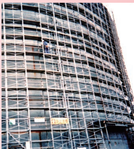
タンク仮設足場
